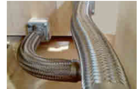
Sezioni flessibili giuntate al trasformatore.
