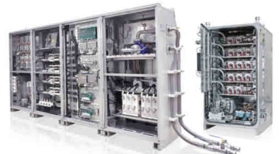
Dotato di un sistema di tubi flessibili corrugati di Angst+Pfister perfettamente installati: il convertitore di trazione di ABB.
